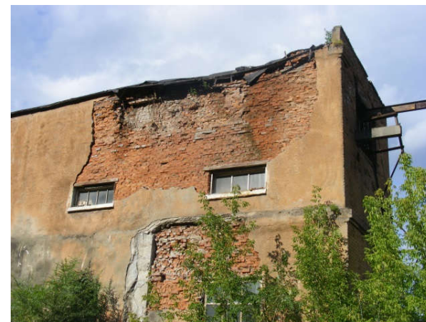
Рисунок 1 – Разрушение кирпичной кладки стены водами с кровли
