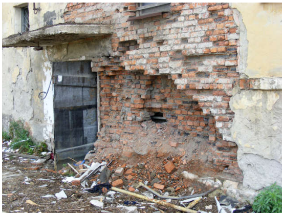
Рисунок 2 – Разрушение кирпичной кладки стены канализационными стоками из критически изношенных трубопроводов канализации
