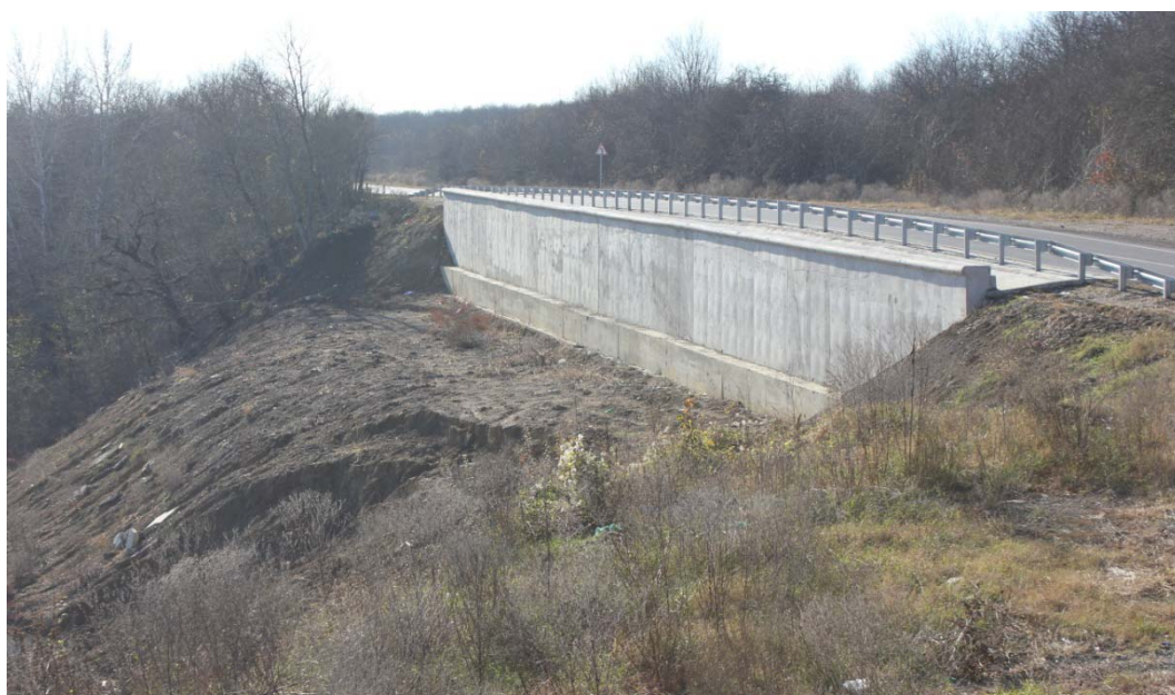
Рисунок А4 – Инженерная защита на участке автодороги Горячий Ключ-Хадыженск
